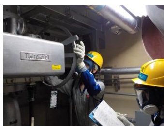
高圧代替注水系 起動操作
