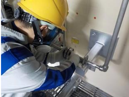
仮設ホース接続
