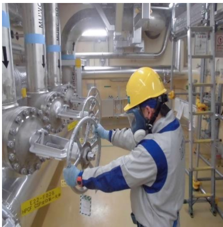
復水貯蔵槽出口ライン隔離
