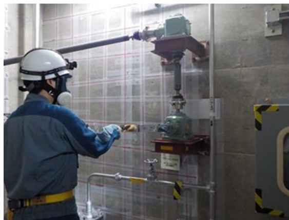
ベント操作（遠隔手動弁操作設備）
