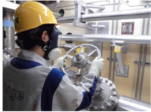
復水移送ポンプ吸込ライン切替え
