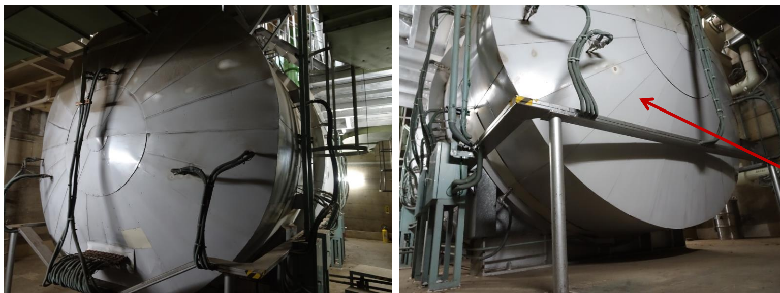
2次冷却材ダンプタンク
