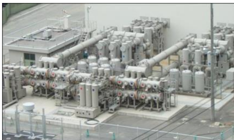
図 3-8 220kV 開閉所の外観
