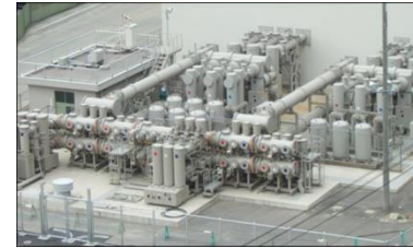
(a) 220kV 開閉所
