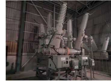
(b) 66kV 開閉所 (屋内)
