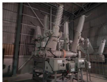
(b) 66kV 開閉所（屋内）
