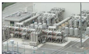
(a) 220kV 開閉所
