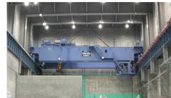
受入れ区域天井クレーン
