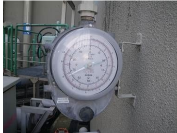
図4 復水タンク水位計
