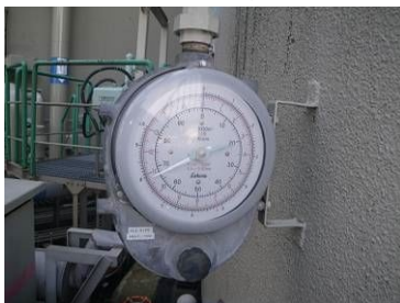
図4 復水タンク水位計
