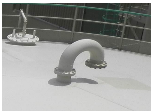
図5 復水タンクベント管
