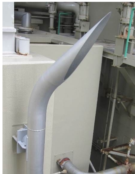
図 1 タービン動補助給水ポンプ蒸気大気放出管の設置状況
