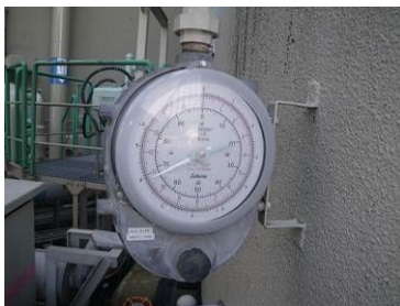
図4 復水タンク水位計
