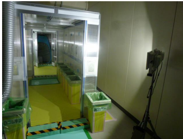
図 1.1-10 チェンジングエリア用照明確認状況
