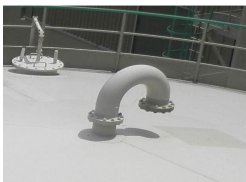
図5 復水タンクベント管
