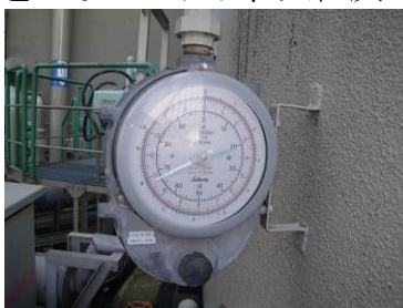
図4 復水タンク水位計
