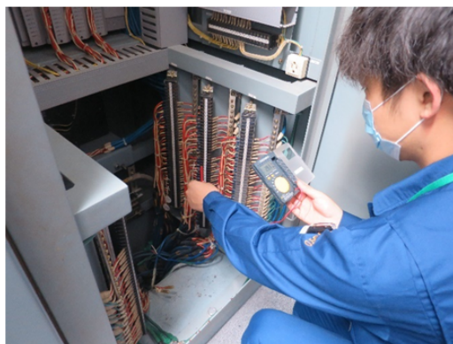
仮設計器による温度確認の一例
