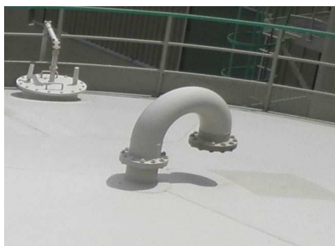
図5 復水タンクベント管
