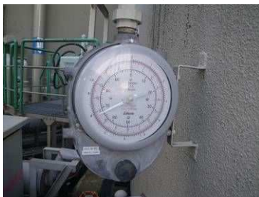
図4 復水タンク水位計
