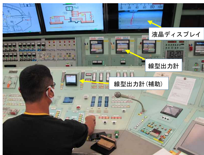
写真H-1 制御室の制御卓（運転中）
