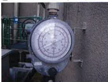
図4 復水タンク水位計
