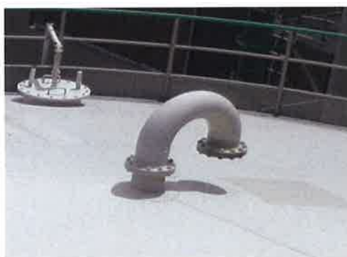
図5 復水タンクベント管
