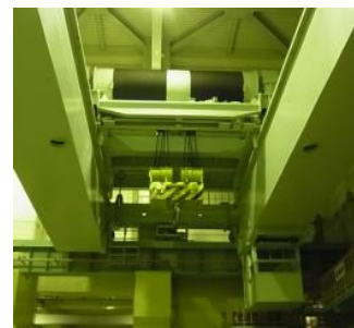
原子炉建物天井クレーン
