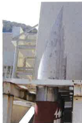
図3 主蒸気安全弁（排気管）の設置状況（3号炉）
