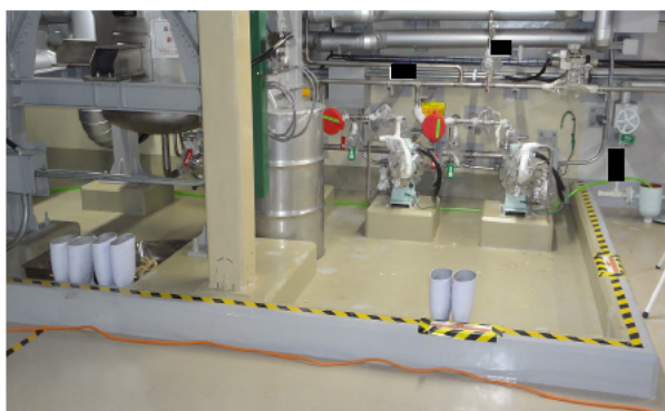
第1図 法令に基づき設置している堰
