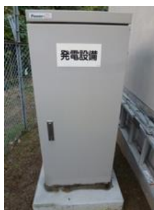
(非常用発電機の写真)
