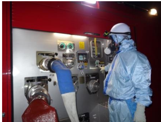
ポンプ起動操作（夜間）
