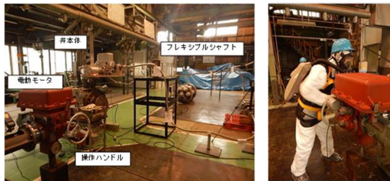
ベント操作（遠隔手動弁操作機構）
