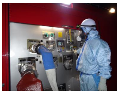
ポンプ起動操作（夜間）
