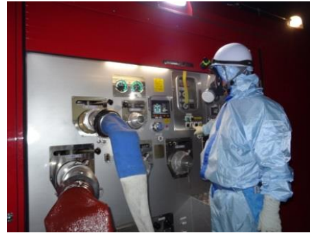
ポンプ起動操作（夜間）
