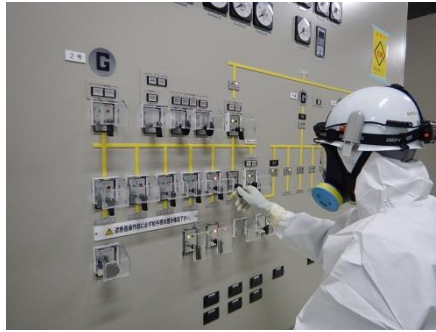
ガスタービン発電機起動操作
