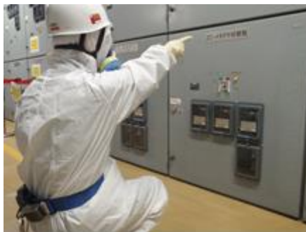
遮断器手動投入
