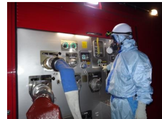
ポンプ起動操作（夜間）
