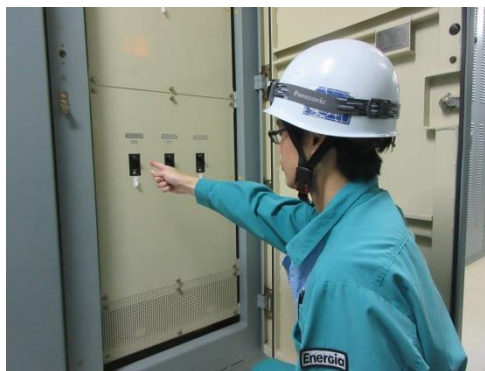
電源切替え操作
