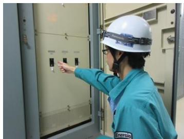
電源切替え操作
