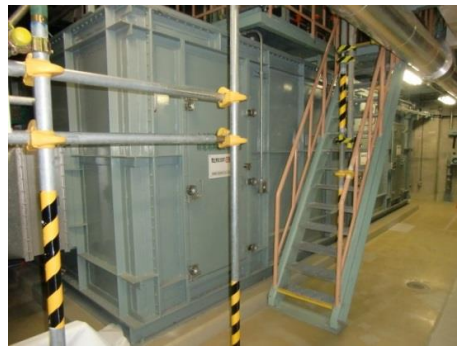
非常用チャコール・フィルタ・ユニット
