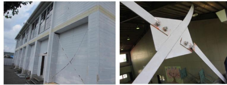
筋かい材の変形
