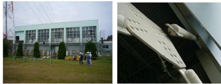
外観 筋かい材プレート破断
