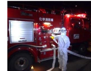
ポンプ起動操作 (夜間)
