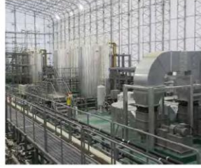
処理水タンク・供給タンク
