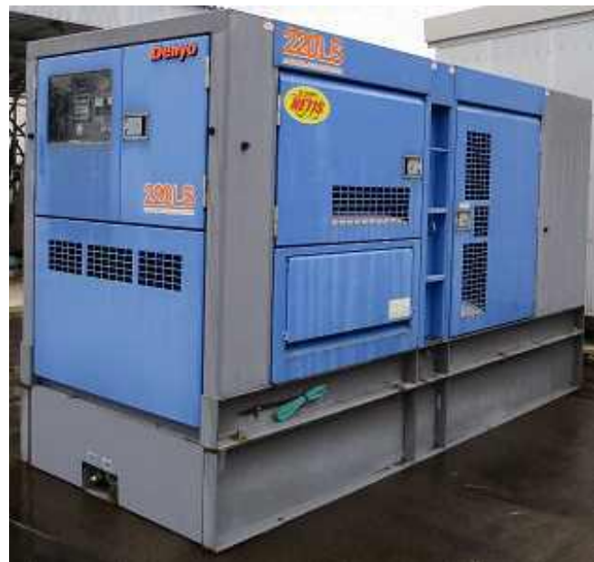
図 4-14 5号炉原子炉建屋内緊急時対策所用可搬型電源設備 外観
