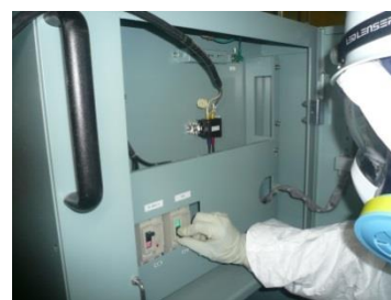
主蒸気逃がし安全弁用 蓄電池の負荷投入操作
