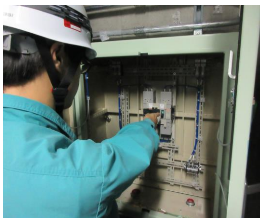
電源切替操作
