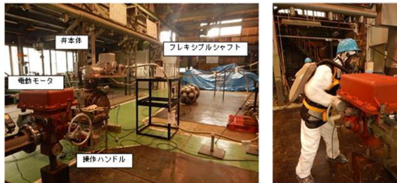
ベント操作 (遠隔手動弁操作機構)
