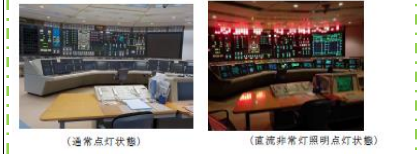
図 2.5-5 非常灯照明下で中央制御室の状況
