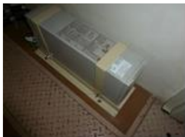
(無停電電源装置の写真)
