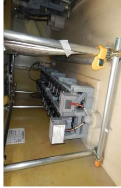
A-原子炉中性子計装用蓄電池 外観
