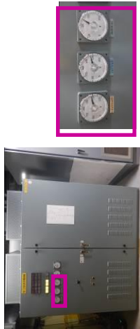
B-115V系充電器外観及び直流電圧計 外観
