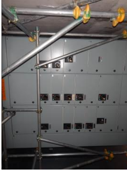
SA 2コントロールセンタ (イメージ)
