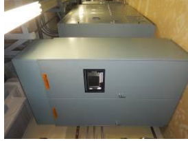
SA 電源切替盤 (イメージ)
