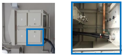
高圧発電機車接続箇所 外観及び接続箇所 (ガスタービン発電機建物南側)
