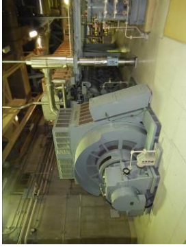
非常用ディーゼル発電機及び 高圧炉心スプレイス系ディーゼル発電機 外観
