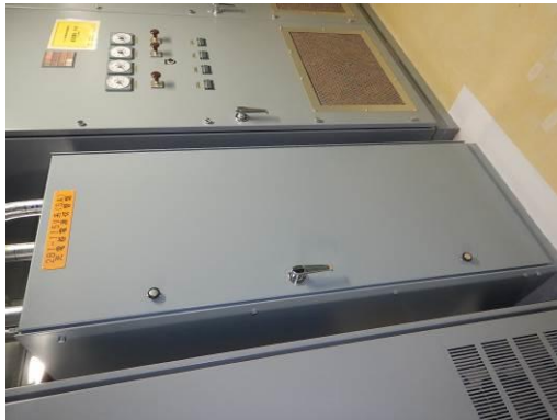
充電電源切替盤 外観
