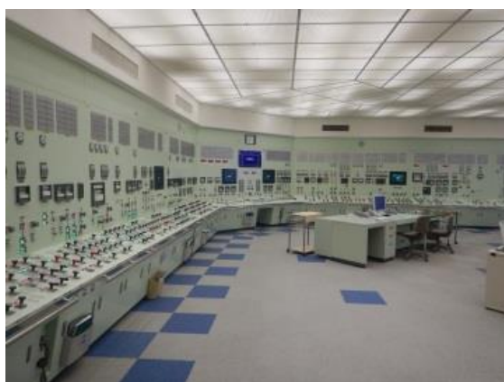
(通常点灯状態)
