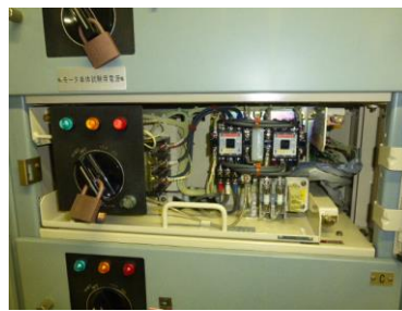
気中遮断器の例 (コントロールセンタ)
