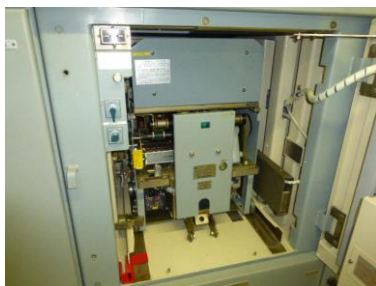
気中遮断器の例 (ロードセンタ)
