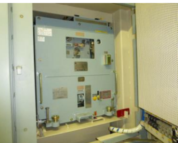
真空遮断器の例 (メタクラ)
