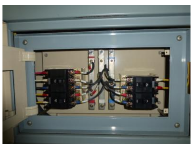
気中遮断器の例 (ブレーカ)
