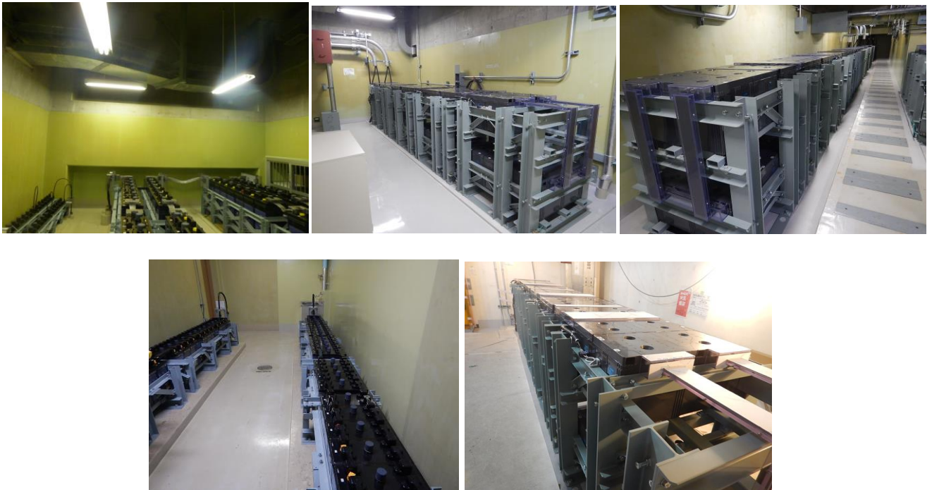
第 41-1-33 図 蓄電池の設置状況 (1 / 9)
