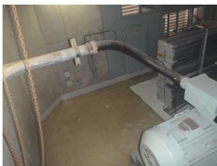
A-非常用ディーゼル発電機室送風機及び可とう電線管
