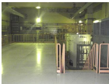
RCW サージタンク及び 計器ラック
