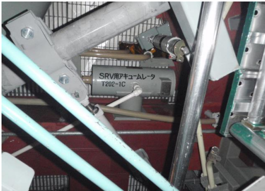
逃がし安全弁逃がし弁機能用アキュムレータ
