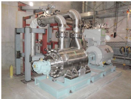
低圧原子炉代替注水ポンプ
