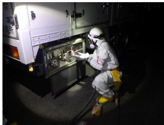
可搬式窒素供給装置 (15m盤 原子炉建物南側)
