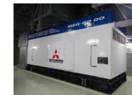
(常設代替交流電源設備の写真)
