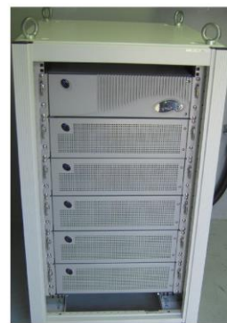
無停電電源装置
