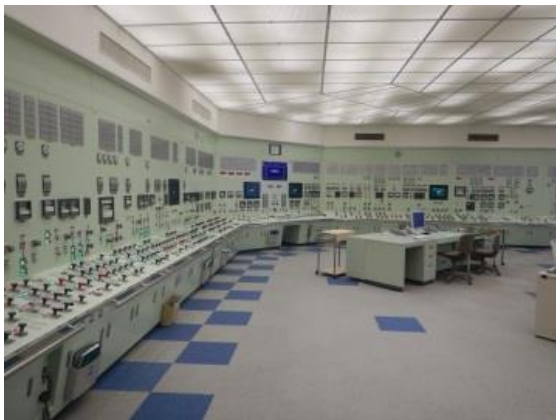
(通常点灯状態)
