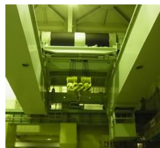
原子炉建物天井クレーン
