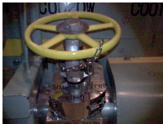
原子炉再循環系ドレン弁（B系）
