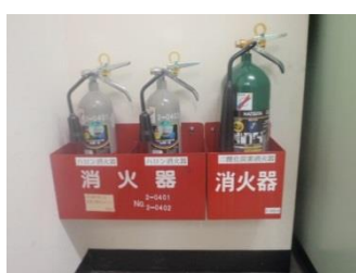
消火器設置状況
