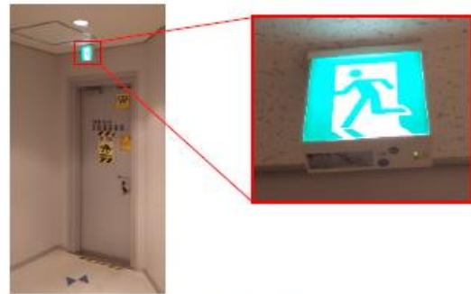
避難口誘導灯
