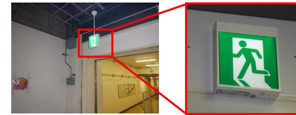
避難口誘導灯
