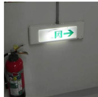
通路誘導灯 (廊下・通路)
