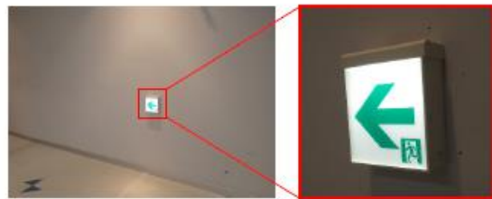
通路誘導灯 (廊下・通路)
