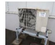
④-14 空調室外機
