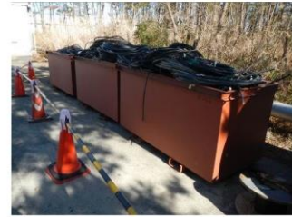
#422 鋼製ボックス
