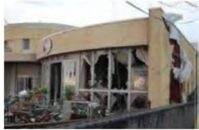
店舗の窓ガラスの被害状況
