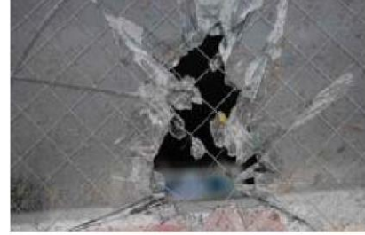
写真 3. 4-36 ガラスへの飛来物の衝突痕
