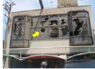
写真 3. 4-22 店舗の窓ガラスの被害状況
