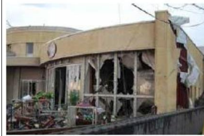
写真 3. 4-21 店舗の窓ガラスの被害状況
