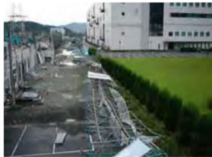
仮設足場の倒壊
