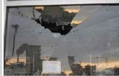
写真 3. 4-35 ガラスへの飛来物の衝突痕
