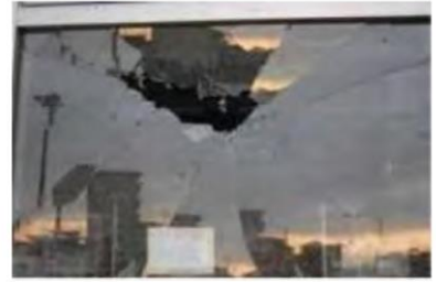
ガラスへの飛来物の衝突痕
