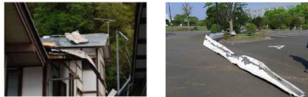
飛来物 (鋼板製屋根材) の衝突
