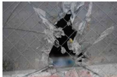
ガラスの被害状況 (飛来物衝突痕)
