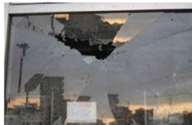
ガラスの被害状況 (飛来物衝突痕)
