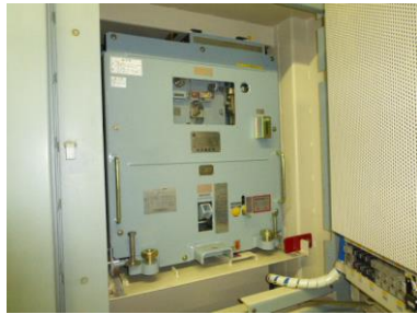
真空遮断器の例 (メタクラ)
