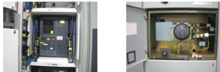
気中遮断器の例 (P/C)
