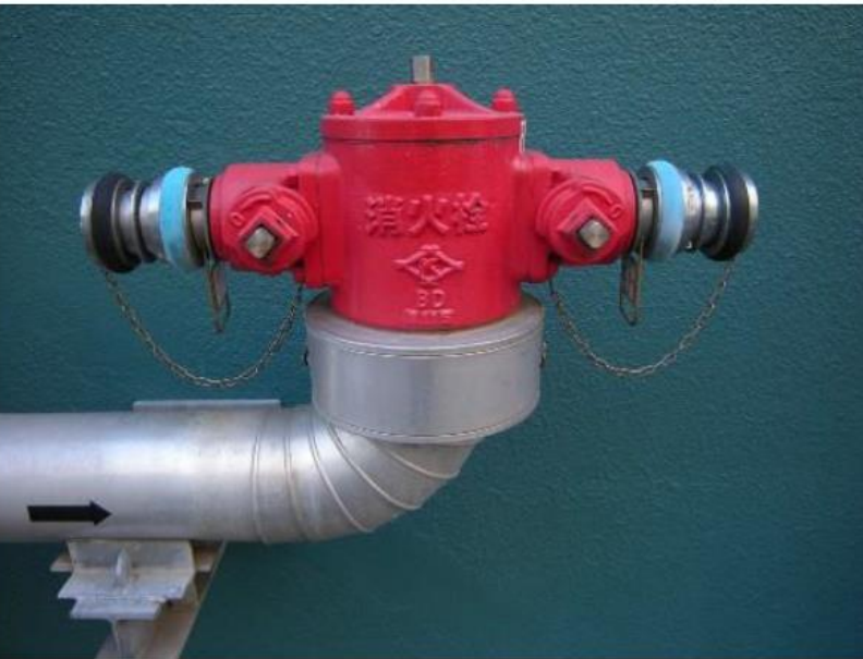
第 1-32 図：不凍式消火栓の設置状況
