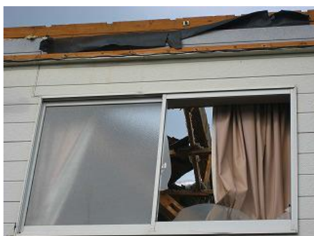
写真 19 窓ガラスの損壊
