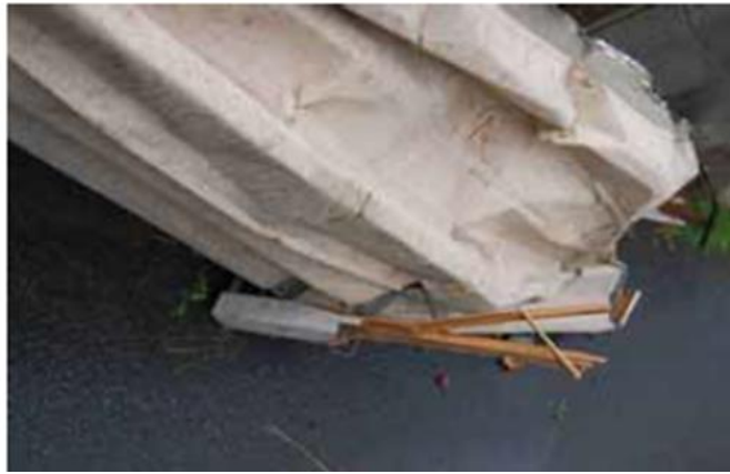
飛散した折板屋根の状況
