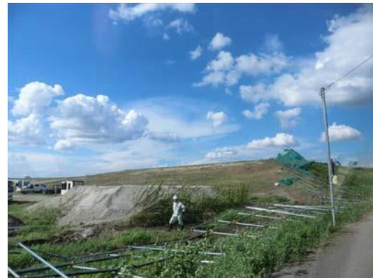
写真 5.2.20 フェンスの被害
