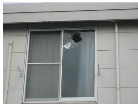
写真 27 窓ガラスの飛来物衝突痕
