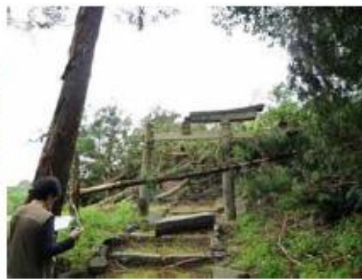
写真 3.5-16 樹木の折損と鳥居の被害
