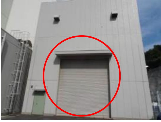
65 サイトパンカ建物西側シャッター
