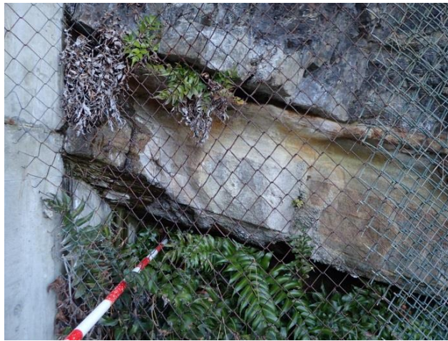
図 2 - 8 ( 1 9 ) 防波壁 ( 東端部 ) 露頭状況 P19 防波扉北側岩着部拡大 岩盤に崩壊するような緩みや高角度亀裂等の顕著な変状は認められない。
