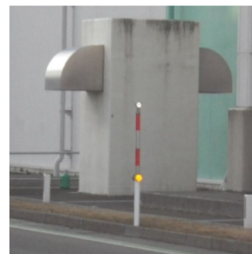
洞道の排気口
