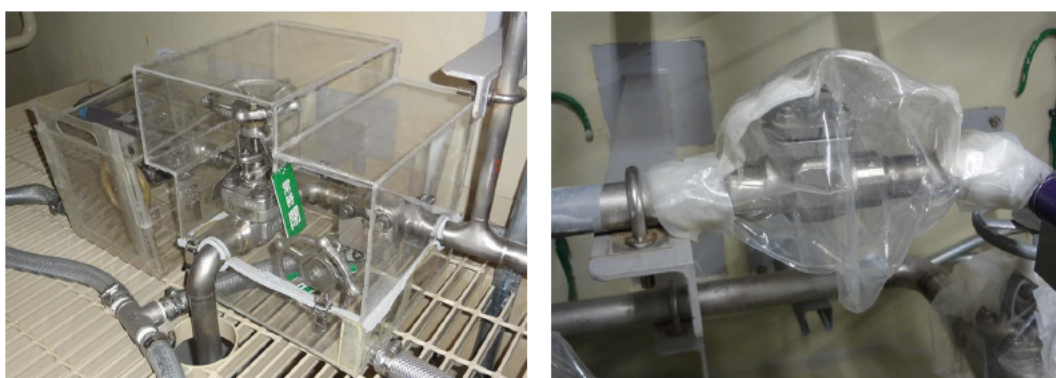
第2図 漏えい化学薬品の飛散防止用の飛散防止カバー等
