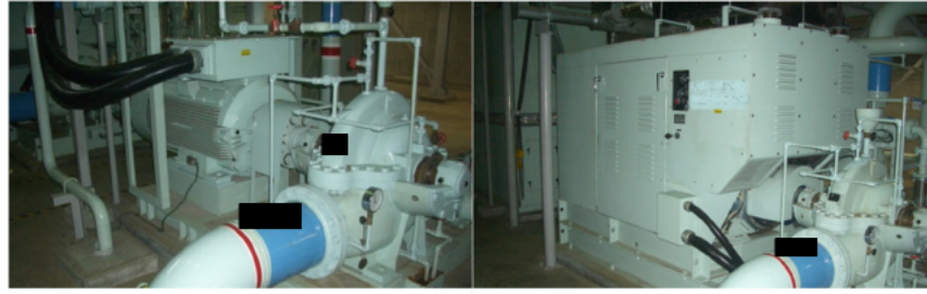
電動機駆動消火ポンプ
