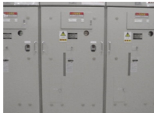
第8図 ガス遮断器
