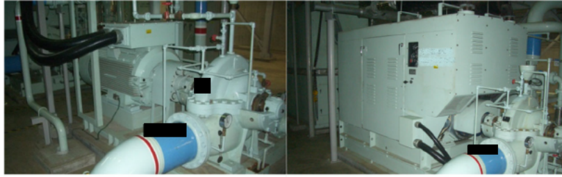
電動機駆動消火ポンプ
